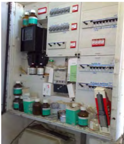
unsachgemäße Lagerung von Arzneimitteln
