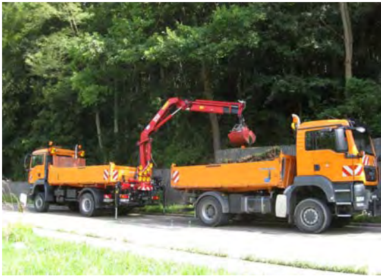
Beseitigung von kleinen Erdrutschungen
